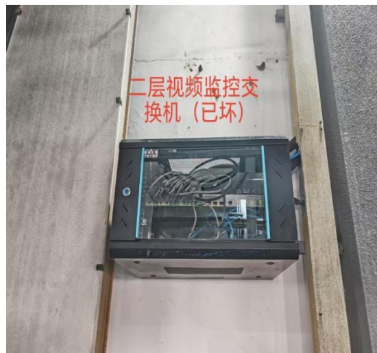
图 26 事故当天视屏监控交换机已坏多日
