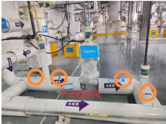
图 22 前后管道上的手动切断阀
